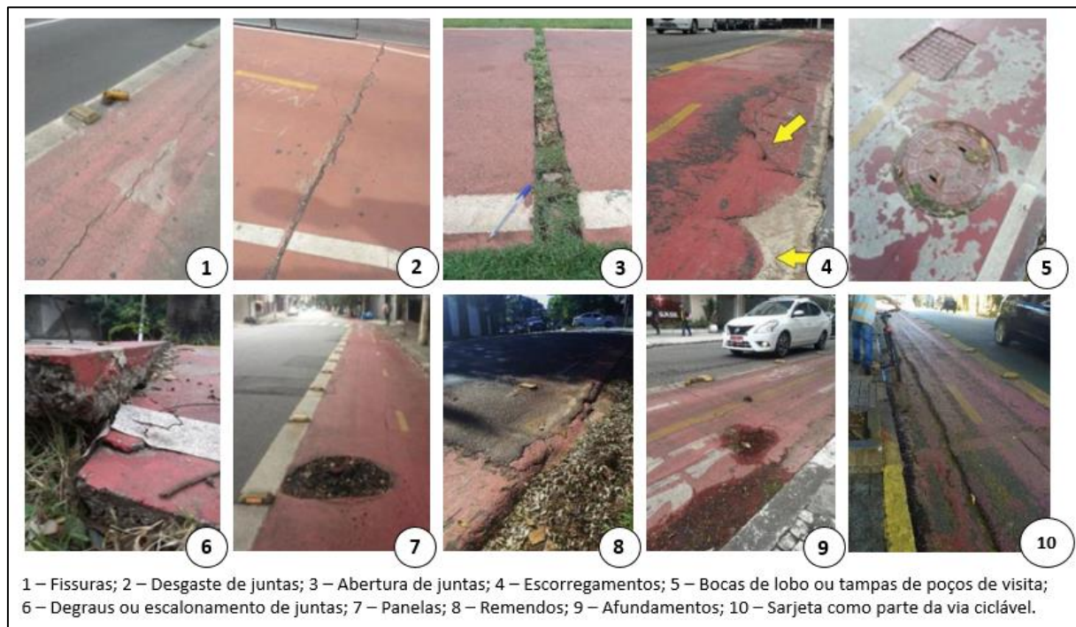
Figura 5.18: Tipos de patologia nos pavimentos cicloviários
