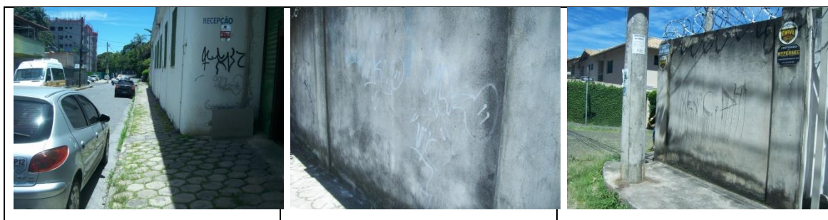
Figura 33 - Sinais de vandalismo e depredação nos segmentos de 3, 4 e 5
