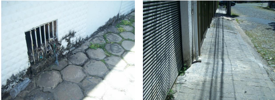
Figura 53 - Lançamento irregular de água da chuva nos segmentos de calçada 3 e 6
