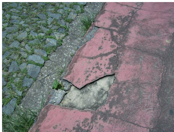
Figura 42 - Buraco no segmento de calçada 1
