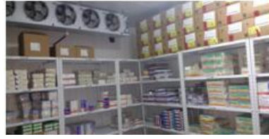
Câmara fria para armazenamento especial em armazém de medicamentos e afins (Q36)
