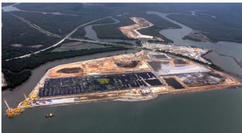
Figura 3.5: Uso de tubos geotêxteis para confinamento de material contaminado dragado do canal marítimo do Porto de Santos e utilização como base da terraplanagem do terreno da área de estocagem de containers (CARVALHO, 2013).
