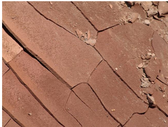
Figura 4.10: Superfície craquelada de rejeito no interior do tubo de geotêxtil.
