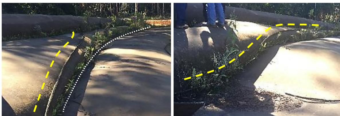
Figura 4.6: Escorregamento entre tubos podendo ser evidenciado pelo deslocamento da costura lateral.
