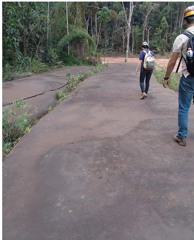
Figura 4.4: Aspecto geral da consolidação da superfície dos tubos geotêxteis após 6 anos do enchimento.
