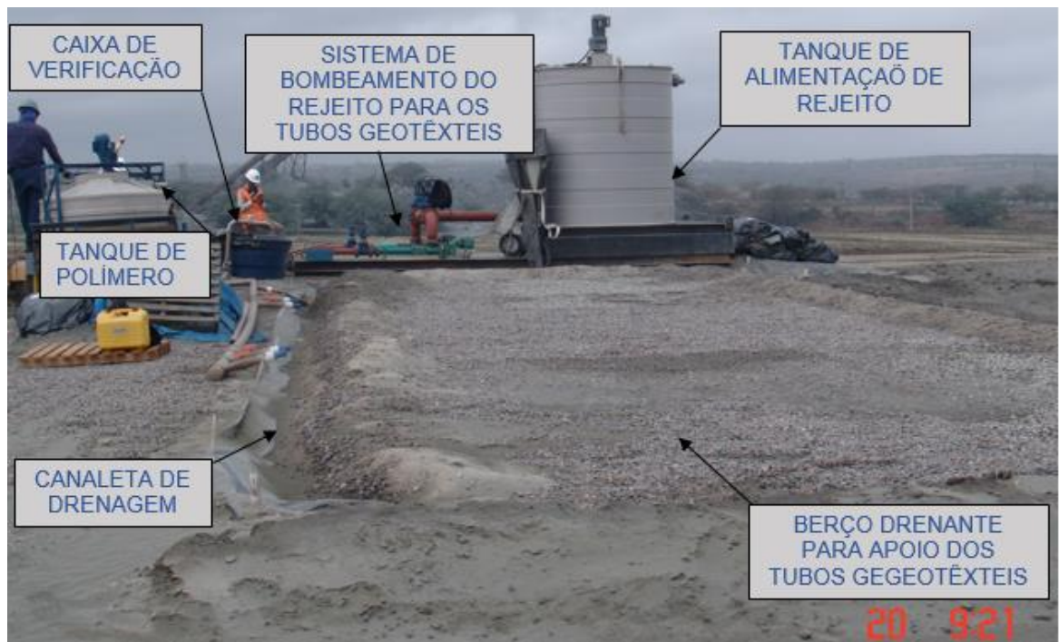
Figura 5.15: Visão geral da área de teste do protótipo em grande dimensão.
