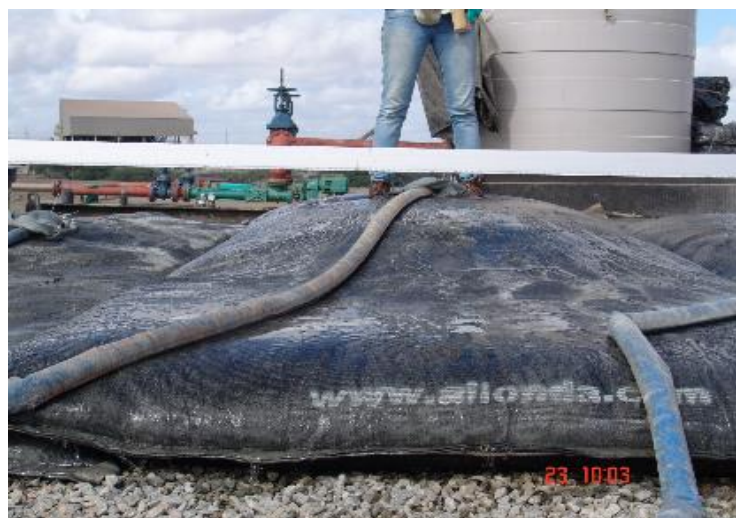
Figura 5.23: Deformação e irregularidade no tubo geotêxtil devido à acumulo de rejeito próximo ao ponto de lançamento.
