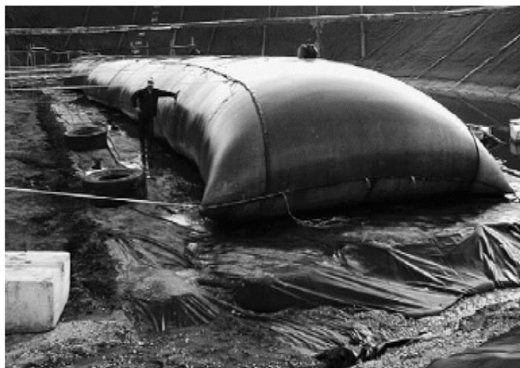
Figura 3.6: Desaguamento com tubo de geotêxtil tecido de grandes dimensões (NEWMAN, 2004 apud MARTINS, 2006).
