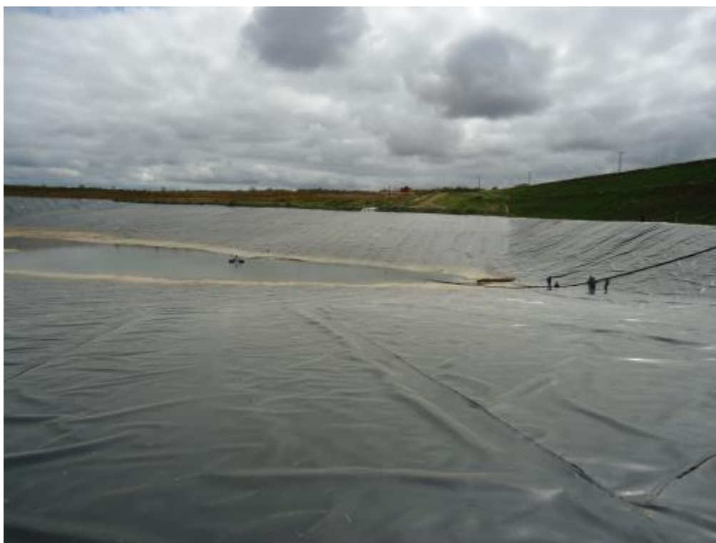
Figura 3-15 – Dique de segurança – Vista HDPE em operação – Ao fundo percebe-se o percolado de cianeto proveniente dos drenos do Lago II
