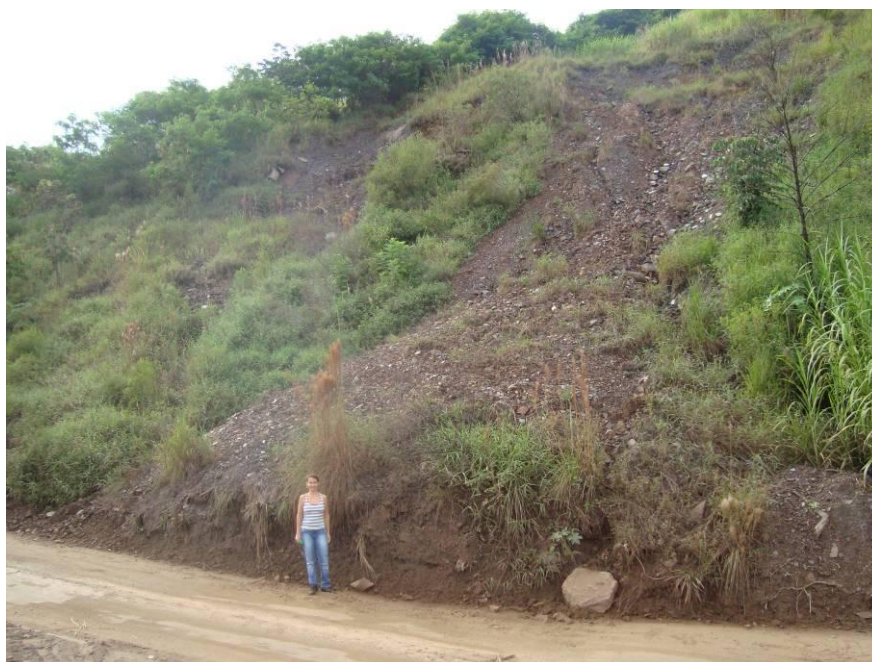
FIGURA 4.14- Corte na base do talude Planetóides (Março/2010).
