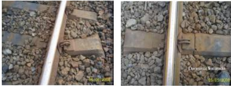
FIGURA 3.22 - Dormentes de aço fraturados. (FONTE – AAR, 2010).
