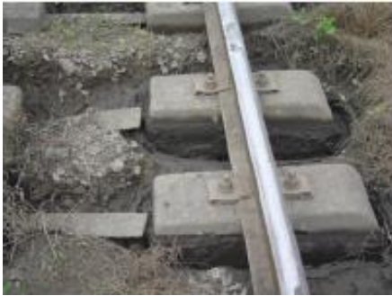
FIGURA 3.23 - Dormentes monobloco com o rompimento do perfil de junção. (FONTE – AAR, 2010).
