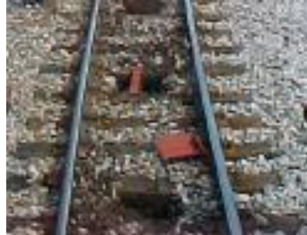
FIGURA 3.24 - Grade da via comprometida. (FONTE – AAR, 2010).
