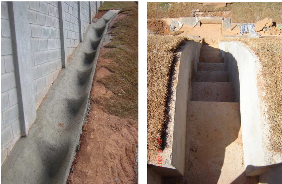
Figura 2.6 - Canaletas de drenagem e descida d`água
