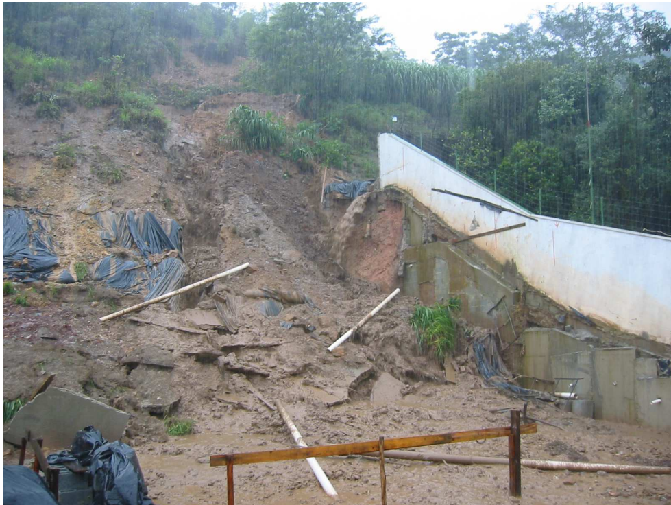
Figura 3.40 – Vista lateral direita da ruptura ocorrida em 17/01/2003 durante o evento
