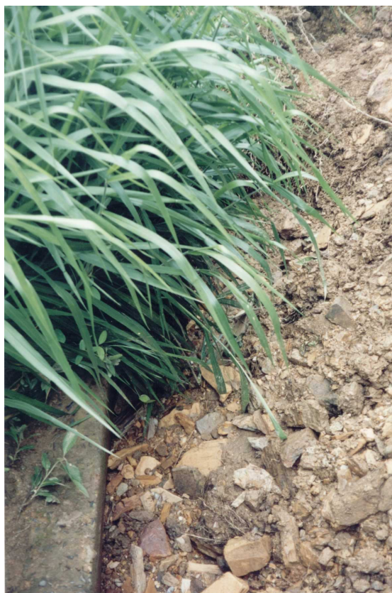
Figura 3.39 - Detalhe da obstrução da calha
