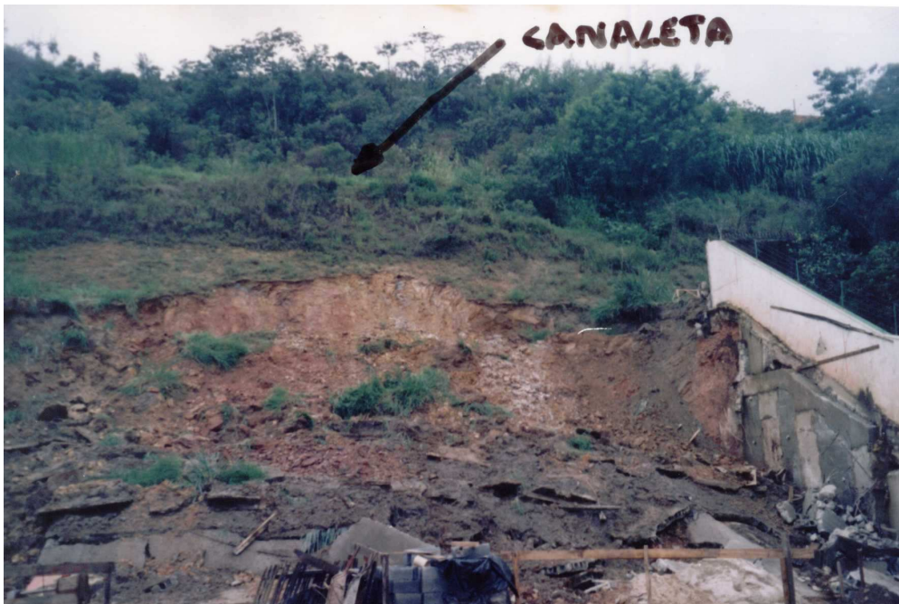
Figura 3.37 - Posição da calha em relação à ruptura
