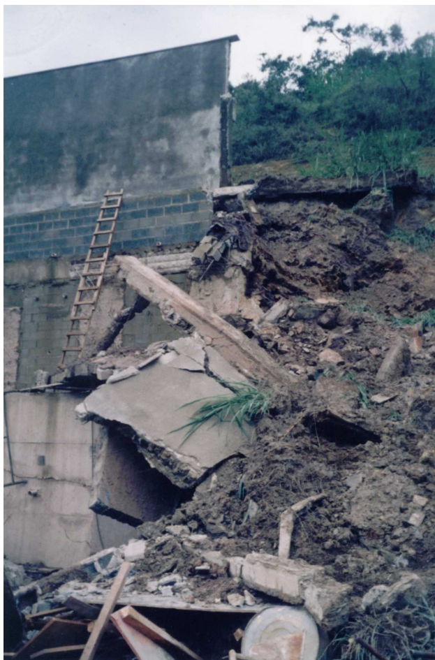
Figura 3.34 - Vista lateral esquerda da ruptura ocorrida em 07/01/2003
