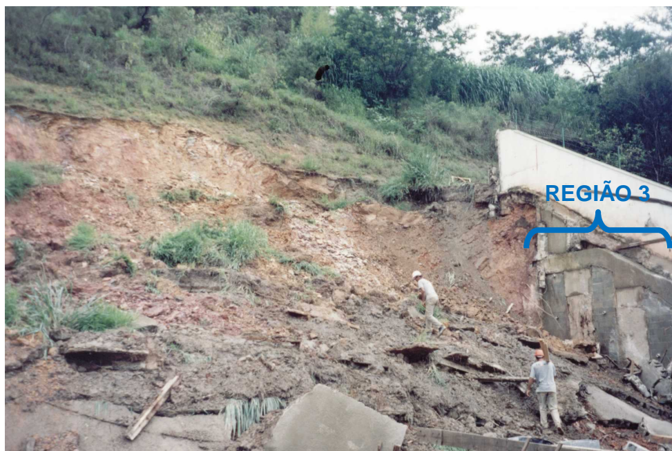
Figura 3.35 - Vista lateral direita da ruptura ocorrida em 07/01/2003 com ênfase à região “3” não estabilizada
