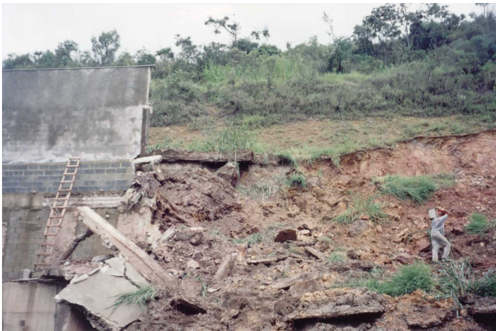
Figura 3.33 - Vista lateral esquerda da ruptura ocorrida em 07/01/2013
