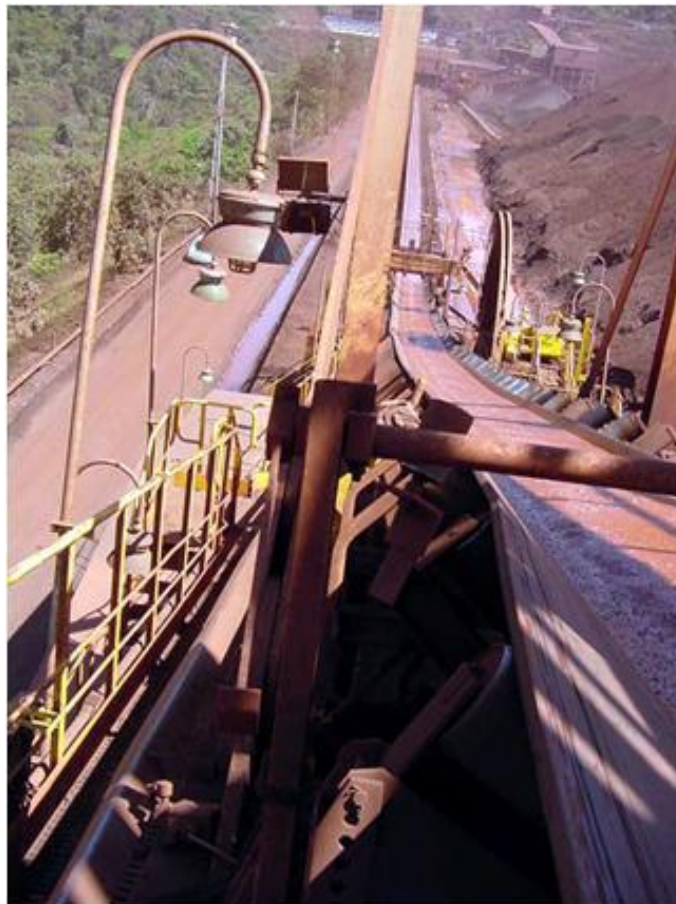
Figura 2.7 - Correia transportadora de minério
