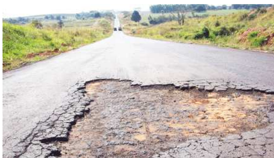
Figura 6.4 - Condição A: possibilidade de contagem dos buracos na via
