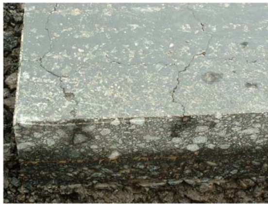
Figura 2.9 – Bloco extraído do trecho experimental onde pode ser observado o padrão de trincamento ocorrido (FRITZEN, 2005).
