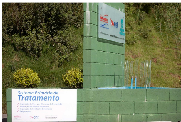
Figura 4.14: Estação de tratamento de efluentes Fonte: GAT Logística.
